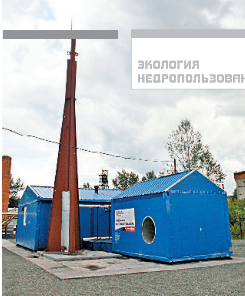
Новая котельная шахты «Красногорская»
