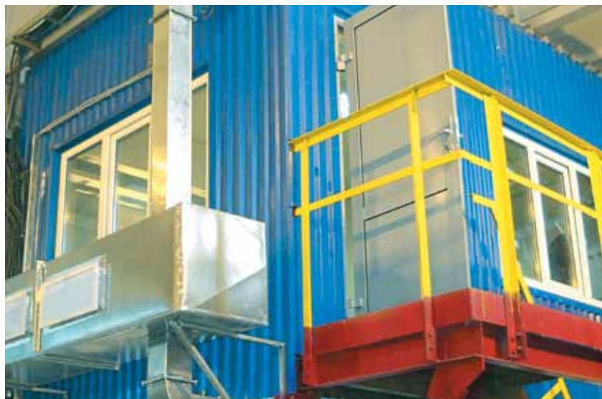
Помещение пульта управления
