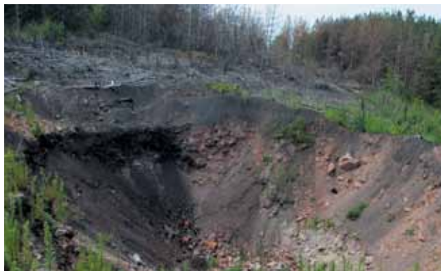
Просадочные явления на рекультивированных территориях
