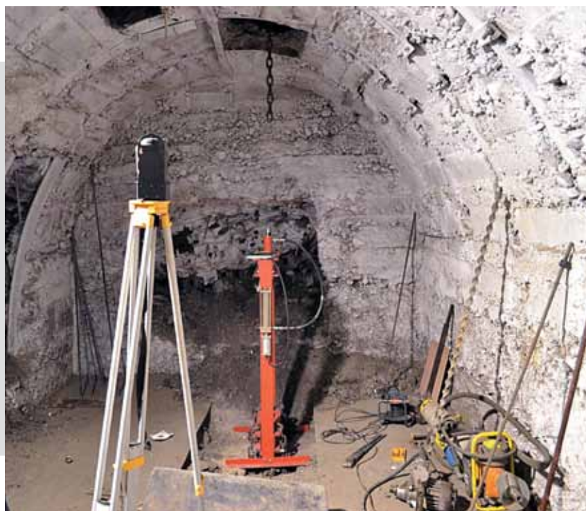
Рис. 1. Общий вид и фрагменты наблюдательной станции в штольне
